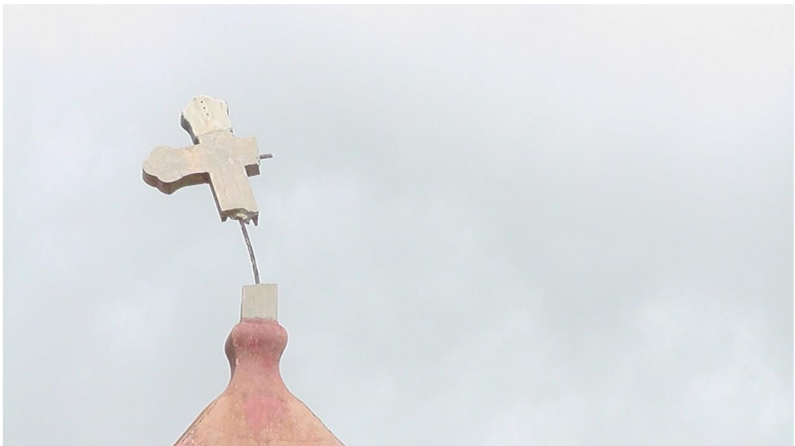
Croix abîmée par le passage du cyclone Irma de Septembre 2017
